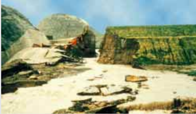
Rupture d'une digue au Lesotho par érosion interne
