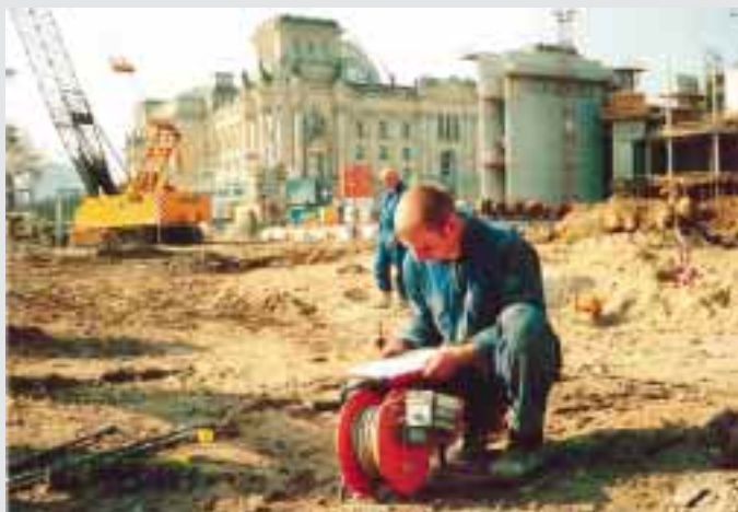
Détection de fuites à partir des mesures de température dans une fouille de construction à Berlin.
