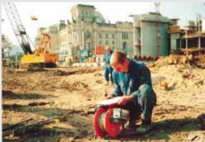
Détection de fuites à partir des mesures de température dans une fouille de construction à Berlin.
