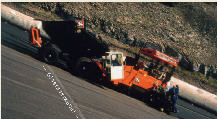
Installation eines Hybrid-Glasfaserkabels in der Asphalt-Oberfächendichtung der Ohratalsperre in Thüringen. Hier wird die Heat-Pulse-Methode zur Leckortung eingesetzt.
