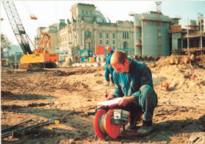
Thermische Leckkantung in einer Trogbaugrube in Berlin
