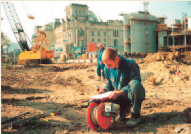
Thermische Leckortung in einer Trogbaugrube in Berlin
