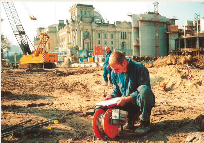
Thermische Leckortung® in einer Trograugrube in Berlin
