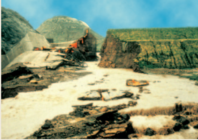
Zerstörung eines Dammes in Lesotho durch innere Erosion am Übergang zwischen Erddamm und Hochwasserentlastungsanlage.
